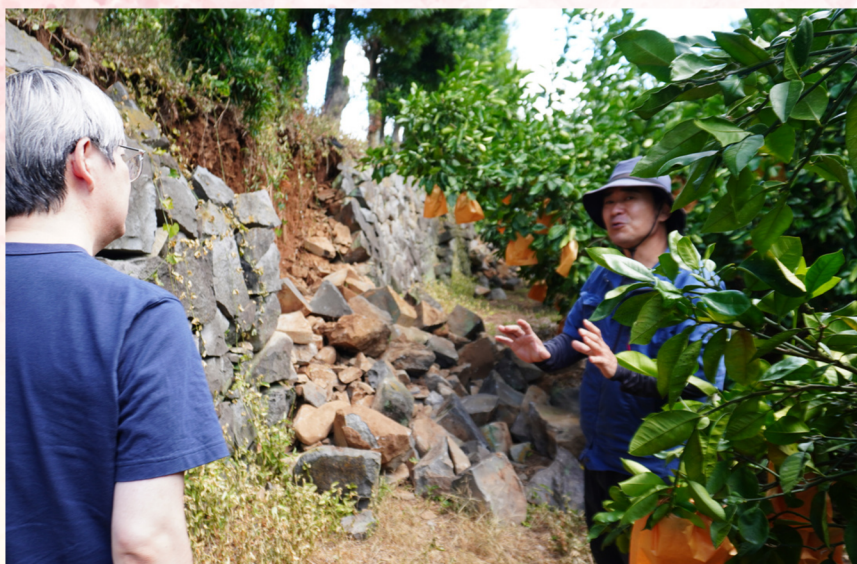
柑橘園場（肥後あゆみの会）の崩れた石垣は、石垣を積める人の確保が見通せず、復旧は未定となっている
